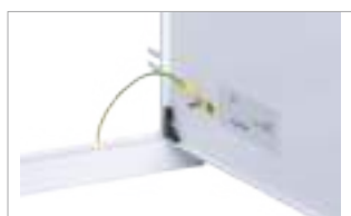
Cable de conexión a toma de tierra
