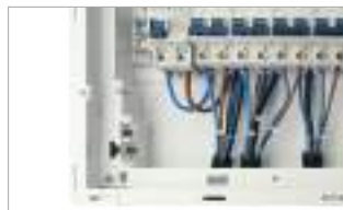
Amplio espacio para el cableado
